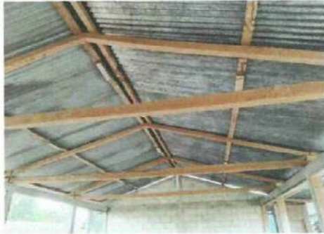
Foto 1: La fotografía evidencia que las costaneras esta en mal estado.
