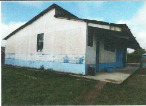
Foto 3: La fotografía evidencia que es necesario pintar las paredes del Centro Educativo.
