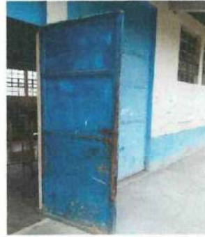
Foto 2: La fotografía evidencia que las puertas del centro educativo estan deterioradas.
