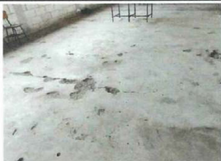
Foto 5: La fotografía podemos evidenciar el mal estado del piso en las aulas del centro educativo.
