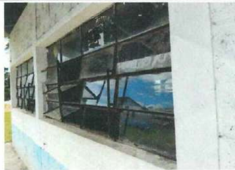
Foto 4: La fotografía evidencia la necesidad del cambio de los vidrios de las ventanas del Centro Educativo.
