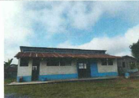
Foto 6: La fotografía evidencia que las laminas estan en mal estado.
